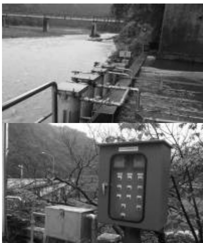
圖 6 濁度懸浮固體偵測器及水質電腦監測系統
