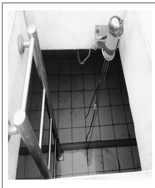
圖 4 調整水塔控制水位的三極棒
