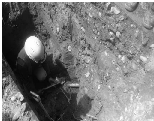
圖 9 開挖發現 40mm 管線
