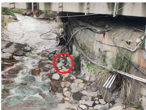
圖 8 漏水皆流入磺溪不易察覺
