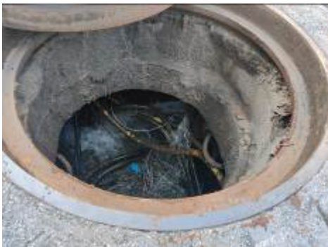
圖 10 台電窰井中有大量流水
