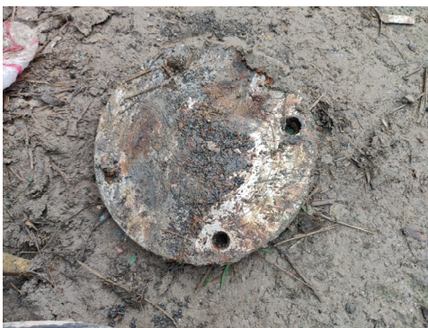
圖 7 閘頭螺栓鏽蝕
