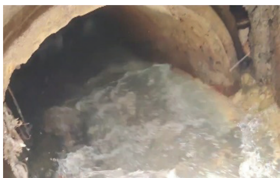
圖 3 側溝過路涵管大量水流
