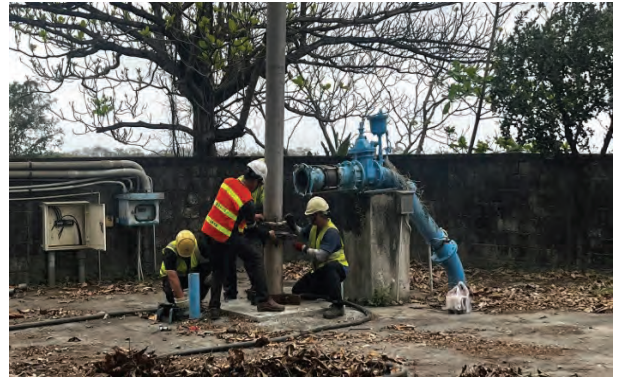
圖 9 緊急啟動新興淨水場備援水井設備
