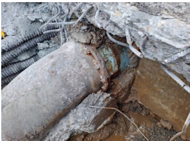
圖 11 中正橋 \phi 600 DI 過橋管接頭脫接
