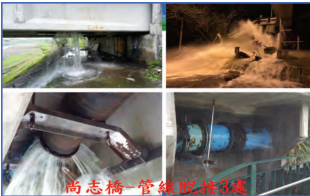
圖 1 花蓮 0206 災情—管線脫接
