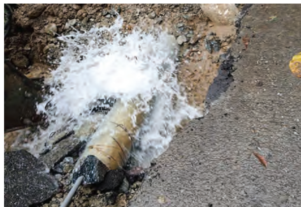
圖 14 富世原水管第二處漏水點 \phi 300 -PVC (距下游禪光寺牌樓 43m、距上游第一處漏水點 72m)
