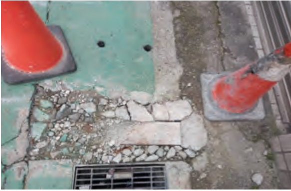
圖 1 蓋版無法完整施工致表面混凝土龜裂
