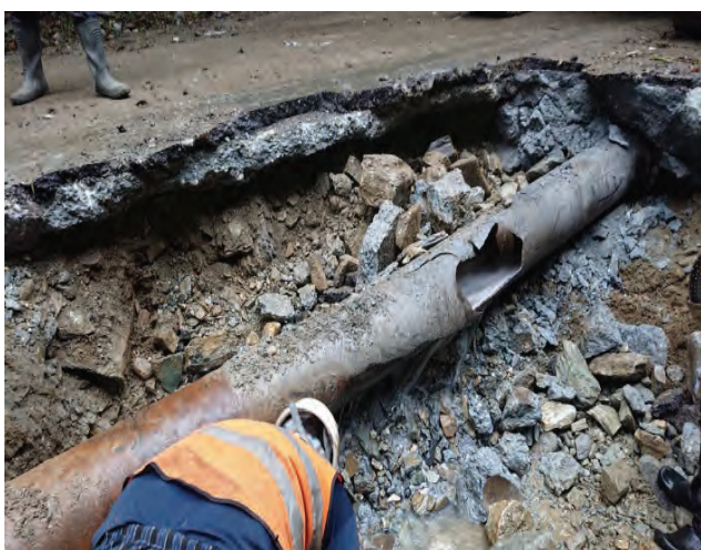
圖 13 富世原水管第一處漏水點遭落石砸損毀的 \phi 300 -DIP，由於管線埋設於溪流側且為堅硬的岩盤結構，路權單位要求，管線應淺埋距路面約 40 公分。
