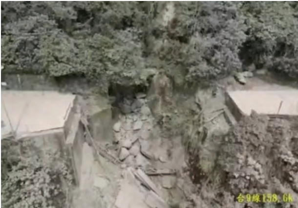
圖 15 左側大清水隧道口前道路坍塌
