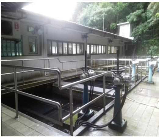
圖 13 陽明淨水場快濾池照片
