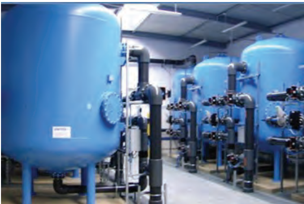
圖 9 地下水除鐵錳設備
