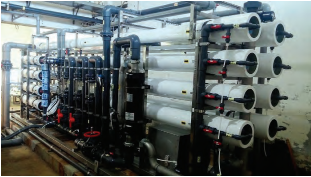
圖 7 海水淡化廠逆滲透薄膜處理單元
