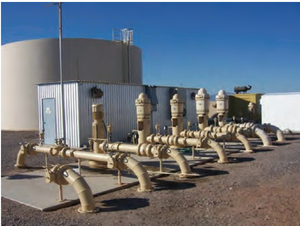
圖 8 地下水井泵浦及管線
