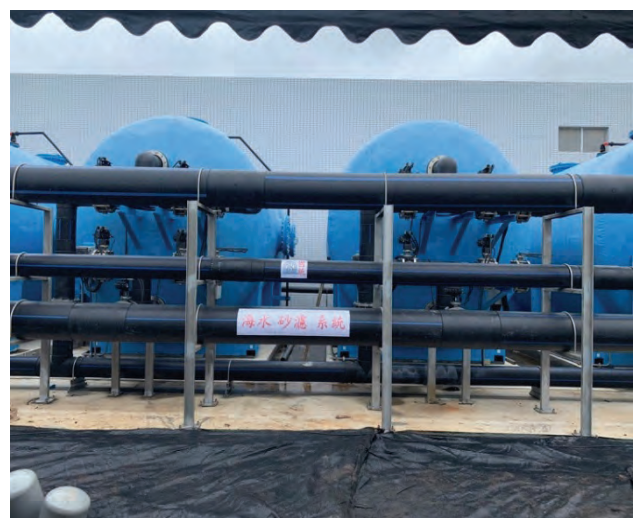
圖 6 海水淡化廠砂濾系統
