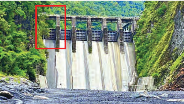
圖 2 台電大觀發電廠武界壩開門(框線處)異常開啟放水
