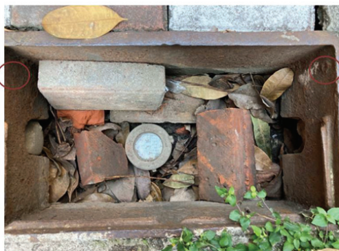
圖 2 水量計箱上蓋支撐結構斷裂
