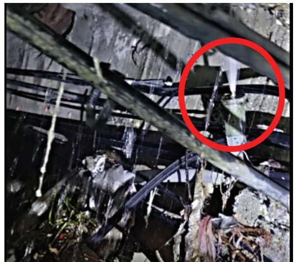
圖 22 大橋下的民用小型減壓閥漏水
