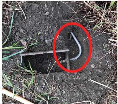
圖 4 不明管線有漏水疑慮
