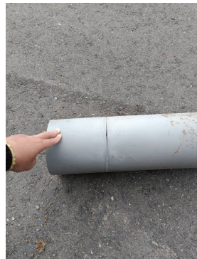
圖 5 竹灣 150mm 漏水環向裂縫型態
