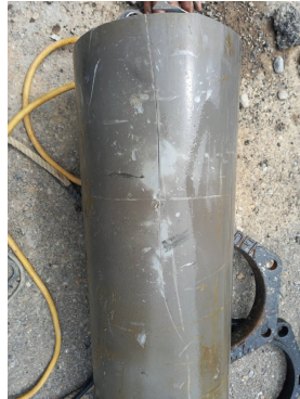
圖 4 縱向裂縫型態
