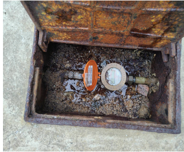
圖 3 表箱內另件的老化腐蝕滲漏
