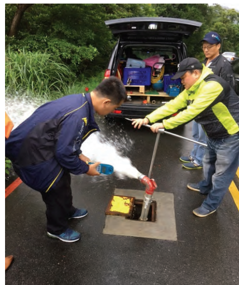
圖 4 管末端消防栓排水及取樣檢測
