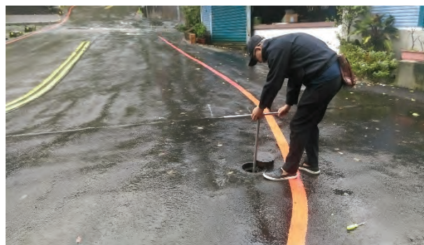
圖 10 調整三配揚水管與四配下水管連通閥
