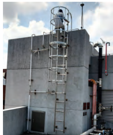
圖 12 較符合安全需求之爬梯（屋頂水池）
