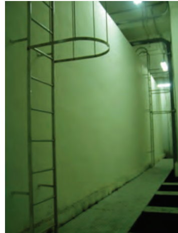
圖 11 較符合安全需求之爬梯（地下室水池）
