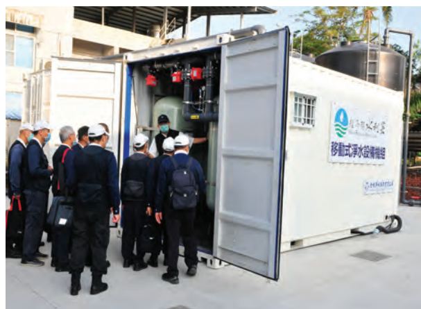
圖 7 放置於台水專業訓練園區的移動式淨水設備
