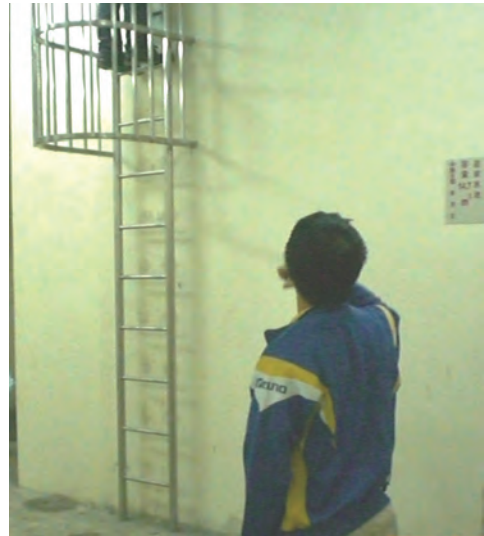
圖 8 踏條與牆面距離不足，形同墊腳尖攀爬
