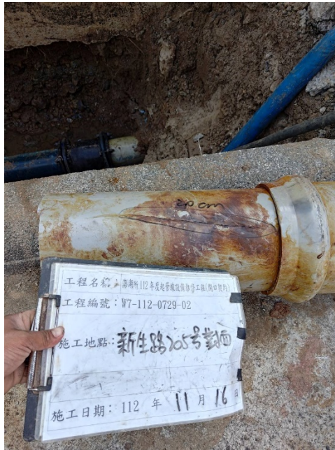
圖 76 200mm PVCP 破管狀況 (張裂型破管)
