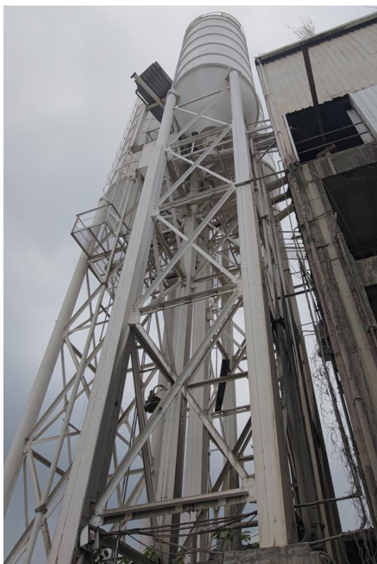
圖 20 拌合設備外觀
