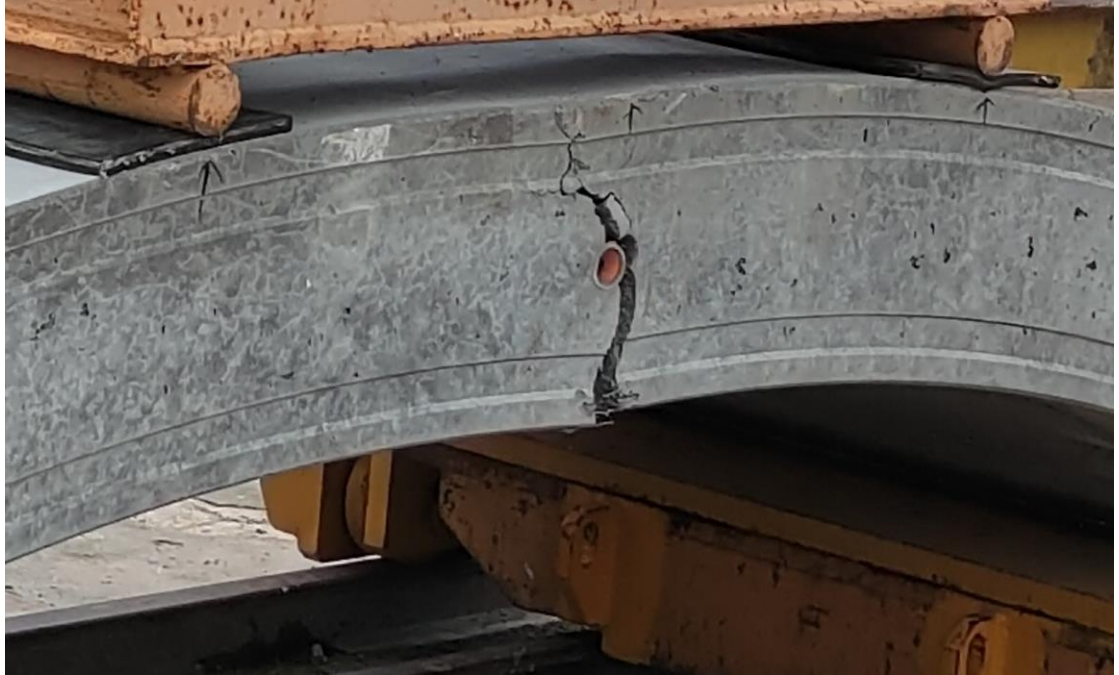
圖 124 鋼纖維混凝土之裂縫放大
