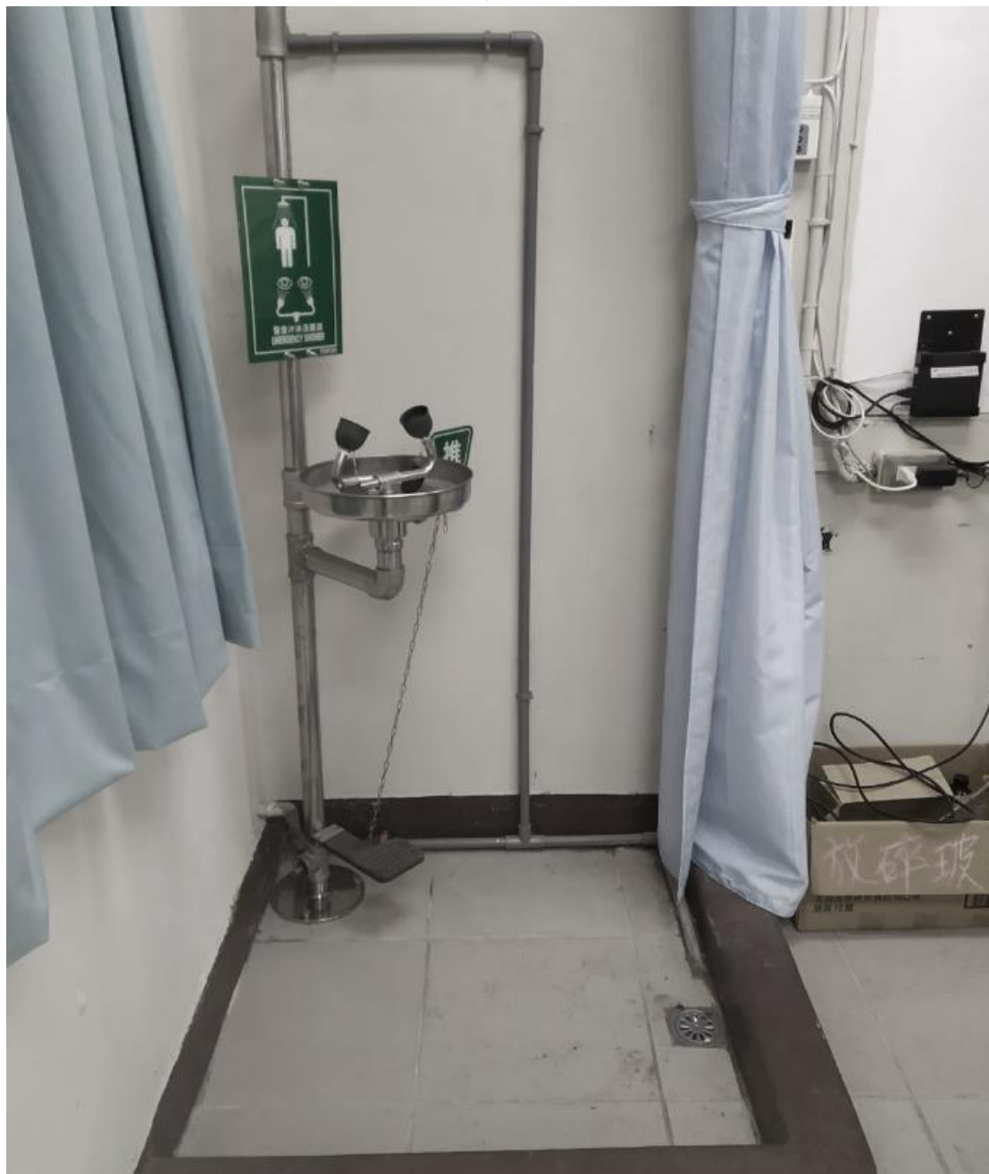
圖 94 案例 B3 校內化學實驗室地下管線漏水
