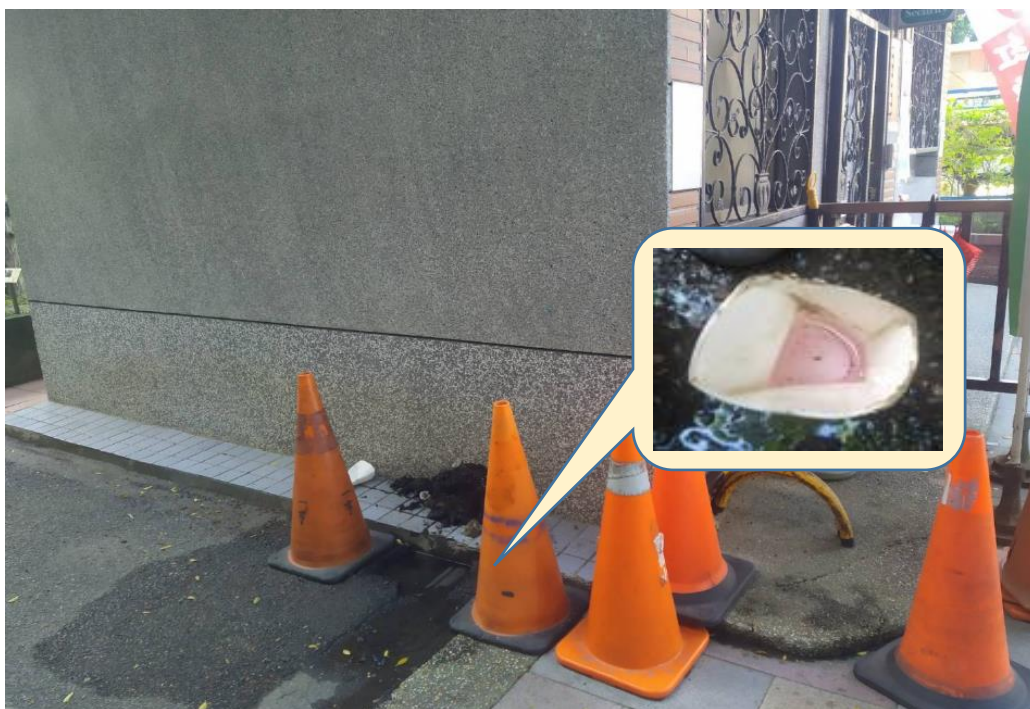
圖 104 案例 B6 發現校門警衛室旁不明積水且確認為自來水
