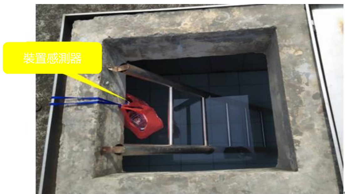
圖 66 水位計實際現場
