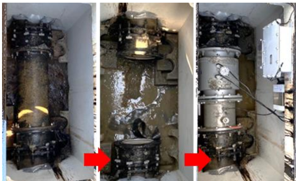
圖 4-5 DSM 流量計現場安裝情形
