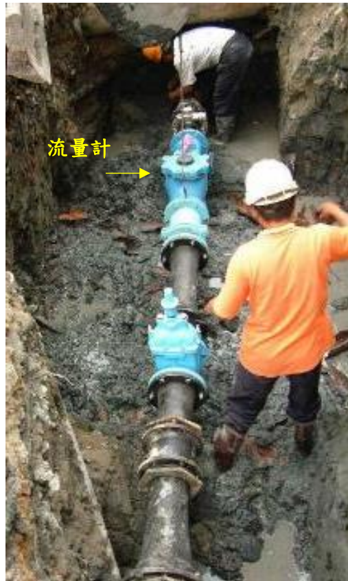
圖 2-6 豎軸葉輪式流量計安裝情形
