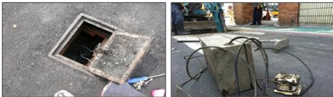
圖 2-7 流量計記錄器安裝於排氣閥箱
