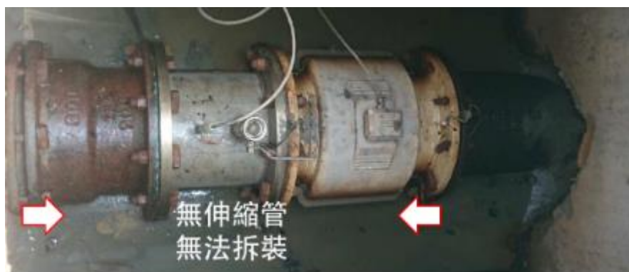
圖 4-17 窰井內管件無延性伸縮管導致無法拆裝流量計
