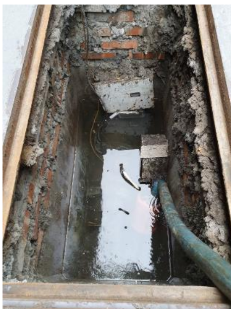
圖 4-6 DSM 流量計傳輸設備於道路銑鋪後摔落損壞
