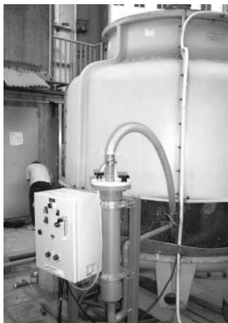
圖 2 冷卻水塔臭氧處理套裝設備
