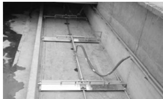
圖 6 吸泥機安裝完成
