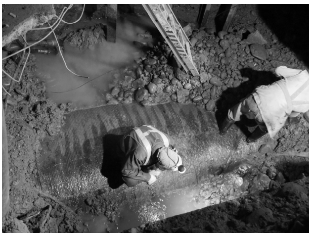
圖 1 \phi 1750mm PSCP 鋼線外露斷裂漏水
